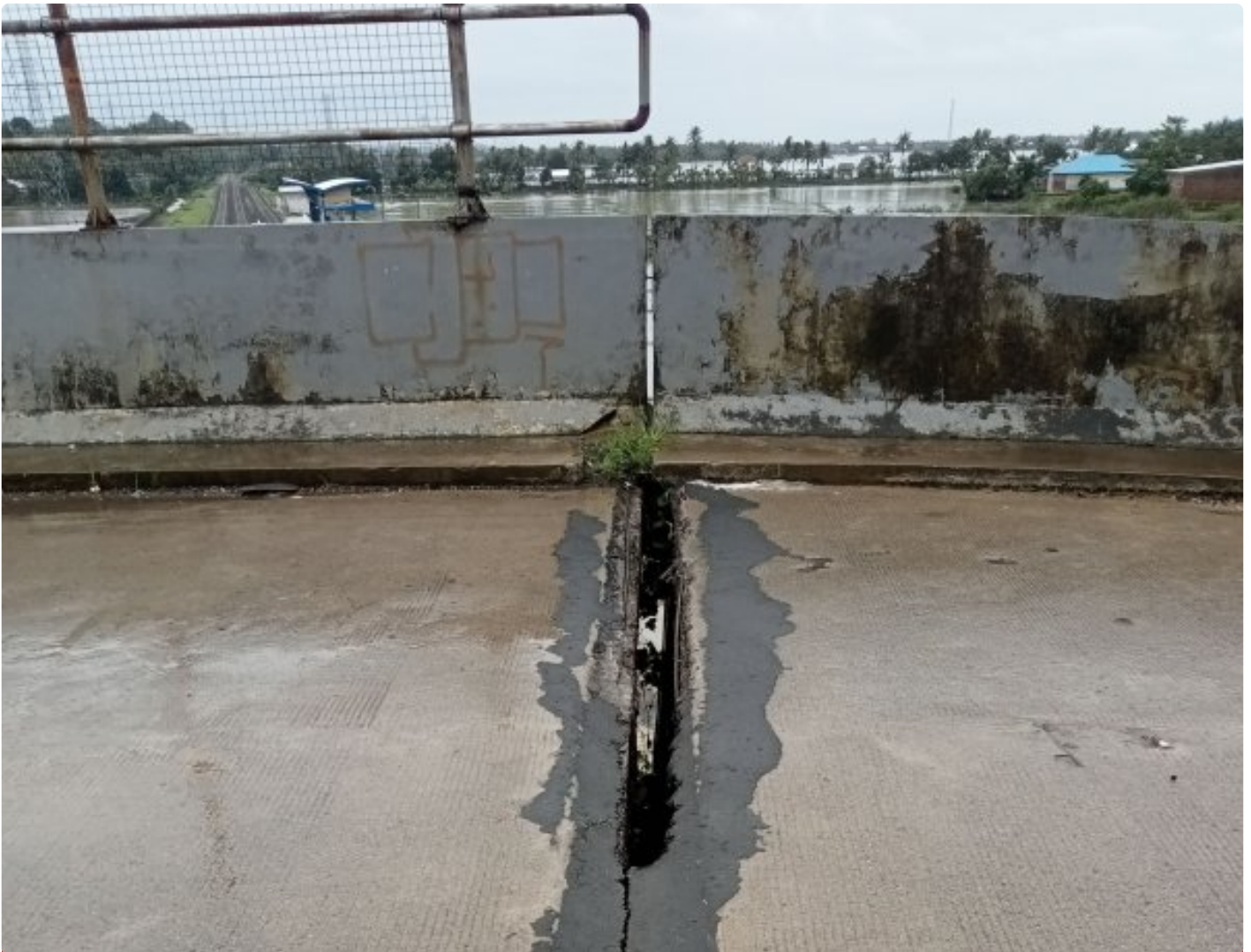
Sambungan jalan fly over Pekkae rusak parah
